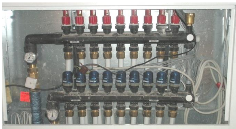
Slika. Razvodni ormar podnog grijanja
