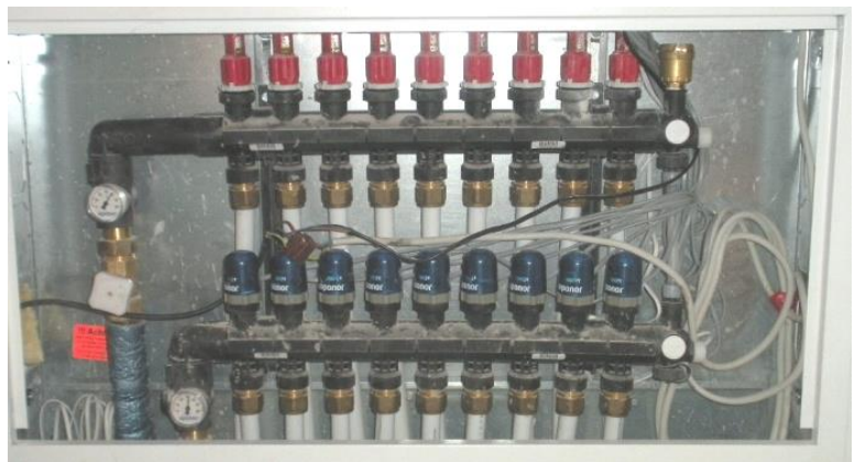
Slika. Razvodni ormar podnog grijanja
