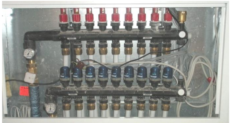
Slika. Razvodni ormar podnog grijanja
